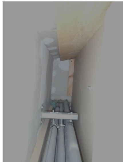
Kuva 182 YP8. Koteloinnin sisällä oli lämpöjohto- linjoja.
