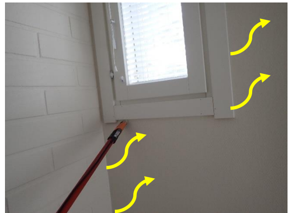
Kuva 97 MA 3 US. Merkkiaineen vuotoa ikkunaliittymästä ja tiiliväliseinän liittymästä.
