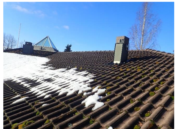
Kuva 54 Yleiskuva vesikatolta, vesikatteessa paikoin sammalkasvustoa.
