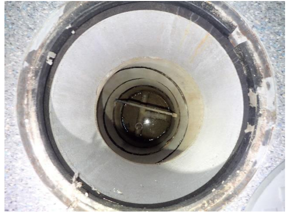
Kuva 53 Betonirengaskaivon syvyys oli noin 3 metriä. Kaivon renkaissa oli näkyviä vaurioita ja kaivon pohjalla oleva pohjaviemärin tarkastusluukku oli veden peitossa.
