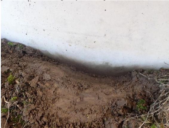
Kuva 32 Sokkelin ulkopinnassa ei havaittu vedeneristettä.
