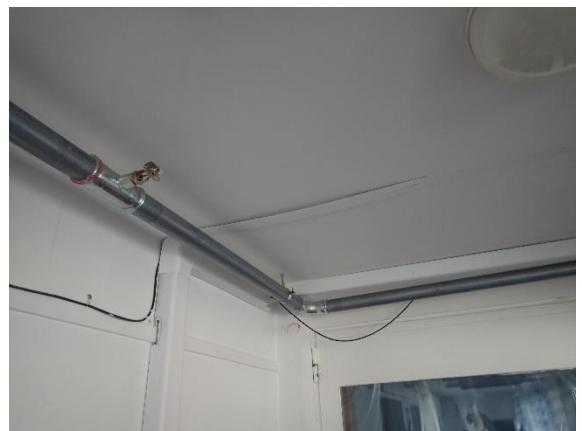
Kuva 210 Irtoamiseen ei havaittu liittyvän vesivauriota. Irtoaminen voi liittyä tehtyyn katto- muodon muutostyöhön.
