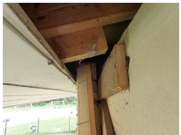
Kuva 83 US8. Puuverhouksen takan oli ristiin koolaus tuulensuojavillan päällä.
