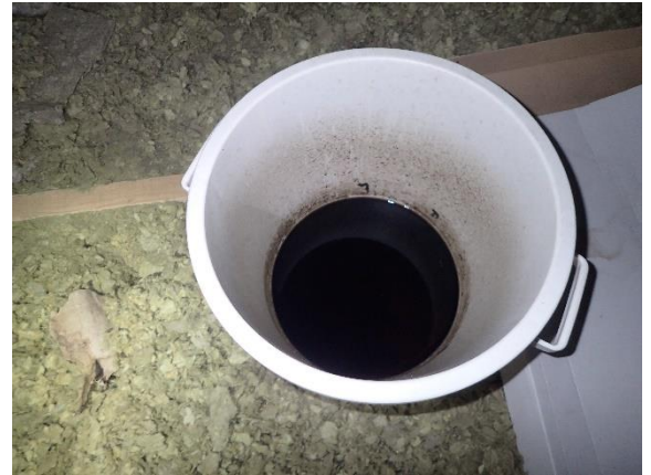
Kuva 172 YP7. Saavin pohjalla oli vettä. Havainnon perusteella kattovuoto voi olla aktiivinen ja puurakenteiden vaurioituminen voi olla jatkuvaa.
