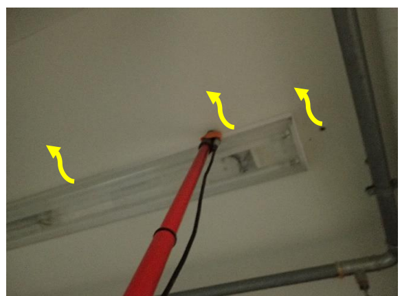
Kuva 241 Merkkiaineen vuotoa alakatossa olevien asennusten taustasta ja levytyksen rei'istä.
