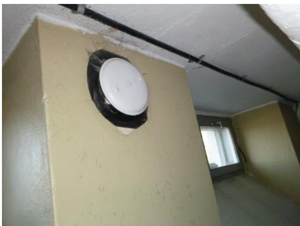
Suljettu epätiivitä alkuperäisen ilmanvaihdon venttiileitä.
