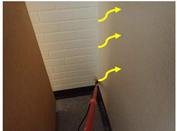
Kuva 132 MA 13 VS. Merkkianeen vuotoa havaittiin levyrakenteen ja tiilimuuratun väli-seinän rajasta.
