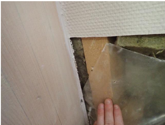
Kuva 22 Ilmansulkumuovia ei mene pilareiden taustalla kirjaston osalla – ilmansulun tiiveydessä todettiin yleisesti puutteita (US2).
