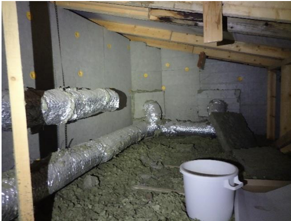
Kuva 171 YP7. Vuotokohdalle oli jätetty saavi.
