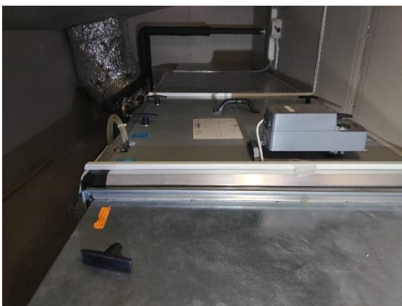
Kuva 203 Näkymä vasemmanpuoleiseen ilmanvaihtokonehuoneeseen.
