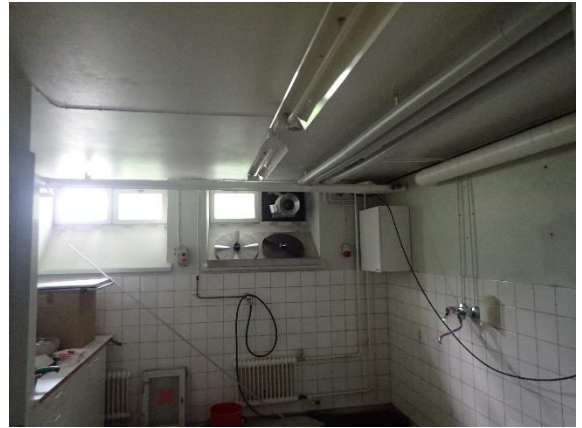
Kuva 225 Kellaritiloissa oli kahteen huoneeseen asennettu kanavapuhaltimet tuuletusikunoihin
