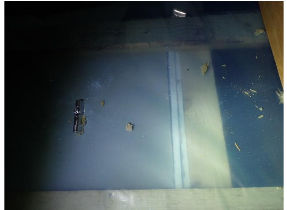
Kuva 150 YP2. Vasemmalla kipsilevytettyä alakattoa. Höyrynsulkumuovin läpäisi ripustusankkuri. Oikealla puolella WC:n ja siivouskomeron alaslaskutilaa.
