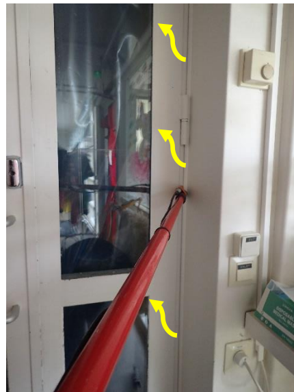
Kuva 235 Yhdyskäytävän suljettu ovi. Merkkiai- neen vuotoa ovikarmin kohdalta oike- asta reunasta.
