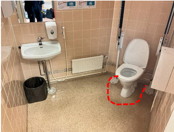
Kuva 48 Miesten wc-tilan lattiassa havaittiin pintakosteusmittauksin viitteitä poikkeavasta kosteudesta pienellä alueella wc-istuimen ympärillä.
