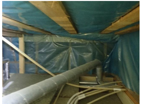
Kuva 152 YP2. Höyrynsulkumuovi oli limitetty ulkoseinälle ja korkeuseron kohdalla. Teippauksia ei havaittu. Ilmanvaihtokanavan pinnalla oli selkeä pölykertymä.
