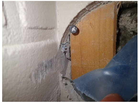
Kuva 124 VS6. Höyrynsulkumuovin ja muuratun rakenteen raja ei ollut ilmatiivis.
