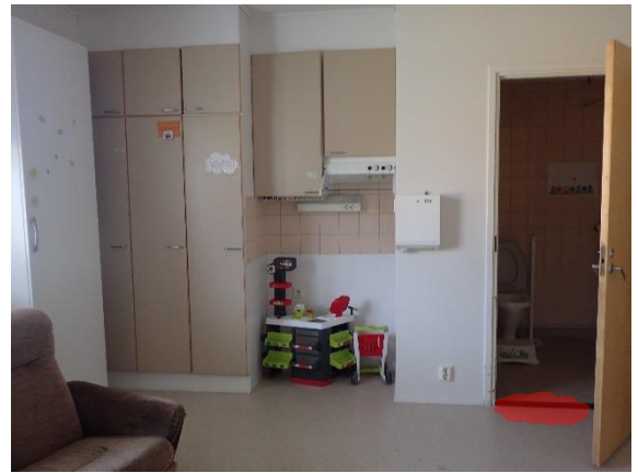
Kuva 35 Huone 2. Muovimattojen kunto li koh- tuullinen. WC-tilan kynnyksen kohdalla havaittiin kosteuspoikkeama RH 96,4%.
