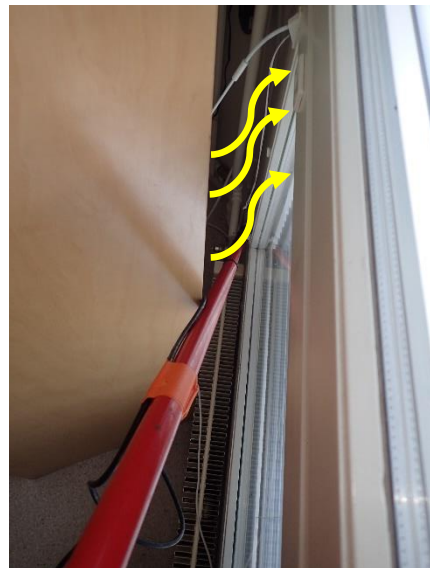
Kuva 103 MA 13 US. Merkkiaineen vuoto erkkerin ja suoran seinän liittymän alueella oli erittäin runsasta. Merkkiainekoe keskeytettiin.
