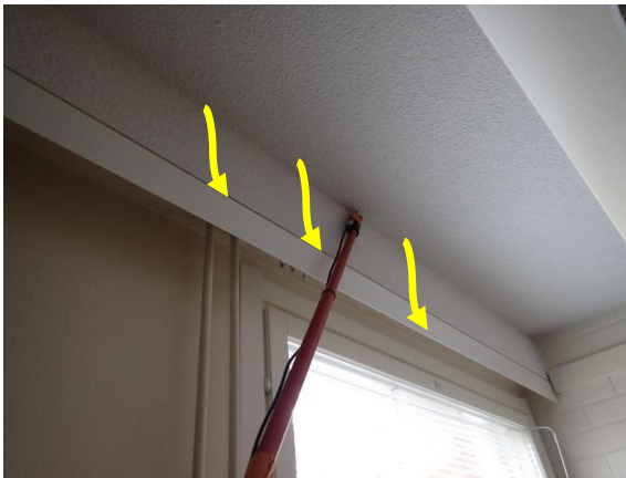
Kuva 131 MA 13 VS. Merkkianeen vuotoa havaittiin yläpohjaliittymässä verholaudan takaa.
