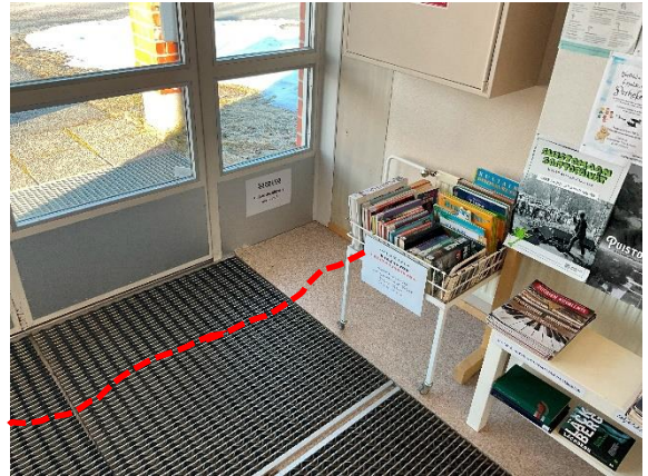
Kuva 49 Tuulikaapin lattiassa havaittiin pintakosteusmittauksin viitteitä poikkeavasta kosteudesta oviaukon edustalla.
