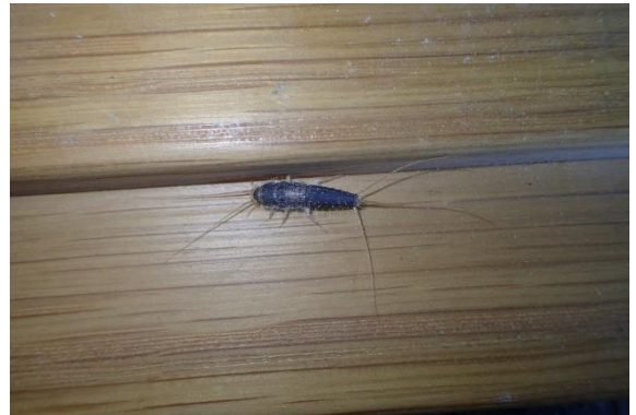
Kuva 55 Levyn alla havaittiin pieneliöitä.
