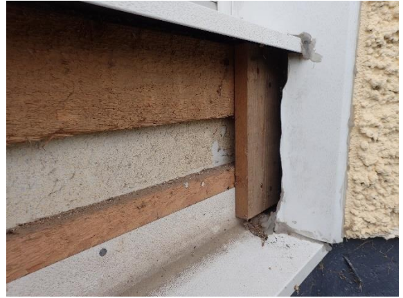
Kuva 77 US1. Erkkerin ja suoran seinäosuuden liittymä oli pellityksen takana epätiivis. Tuulensuojavillan takana oli kivivillaa 100 mm.
