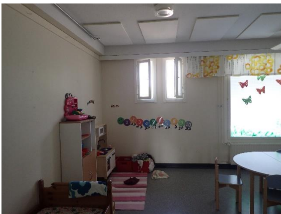
Kuva 161 Tenavat, huone 5. Rakenneavausta YP5 ei tehty ulkoseiniä kiertävän verho-kotelossa olevan lämpöjohtolinjan takia.
