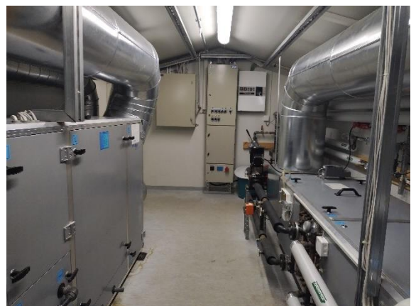
Kuva 204 Näkymä oikeanpuoleiseen ilmanvaihtokonehuoneeseen.
