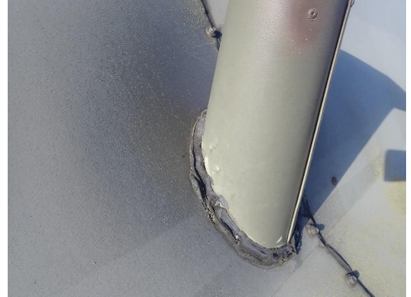
Kuva 56 Vesikatteen läpivientien tiivistysmassaukset olivat ikääntyneitä ja ne olisi lähitulevaisuudessa suositeltavaa uusia.
