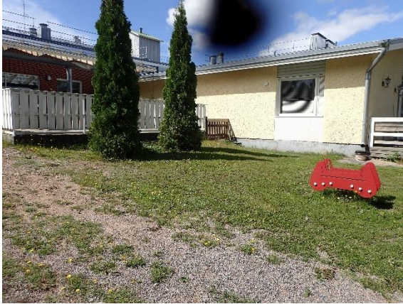
Kuva 4 Rakennukset idästä. Maasto viettää pääosin hyvin poispäin rakennuksesta. Paikoin on rakennuksen vierustan täytömaa painunut.
