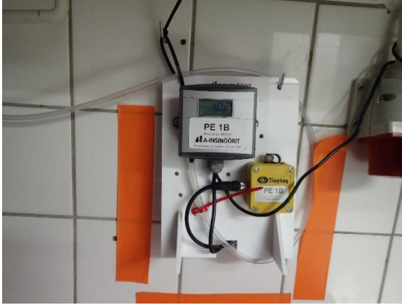
Kuva 228 Keittiötilaan sijoitettu paine-eromittari
