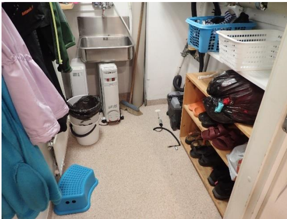
Kuva 42 VM2. Siivouskomerossa todettiin muovimaton alla kosteuspitoisuus, joka ylittää materiaalille sallitun 85 %.
