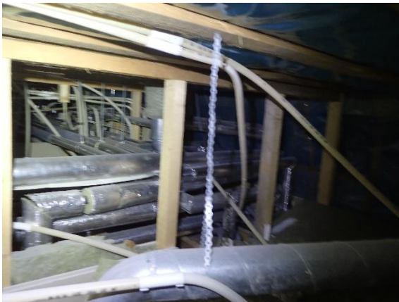
Kuva 151 YP2. Alaslaskutilassa oli runsaasti talotekniikan asennuksia. Näkyvissä oli putkieristeiden suojaamatonta mineraalivillaa.
