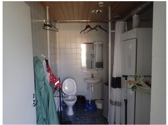
Kuva 43 Yhdyskäytävän alapäässä oleva WC-tila on 2002 rakennusta, vaikka sen lattiakorko on 1992 rakennuksen lattiakoron tasolla. Tilassa oli muista tiloista poiketen lattiapinnoitteena keraaminen laatoitus. Kosteuspoikkeamia ei havaittu.
