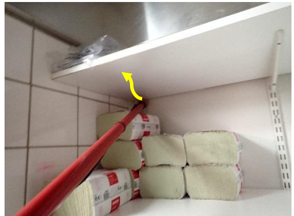
Kuva 243 Merkkiaineen vuotoa laatoitetun seinän nurkasta.
