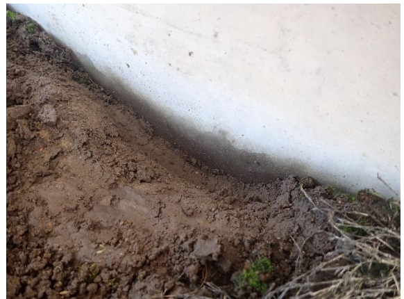
Kuva 11 Sokkelin ulkopinnassa ei ollut havaittavissa vedeneristettä.
