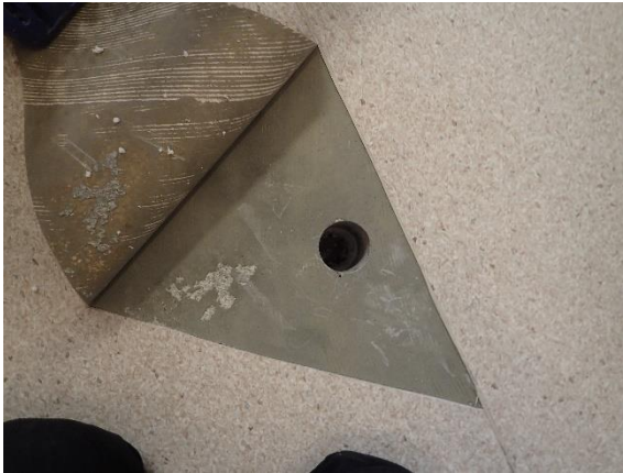
Kuva 40 Rakenneavaus AP10. Muovimaton aukaisun yhteydessä havaittiin muovimaton ja sen liimauksen kosteusvaurioitumiselle tyypillinen haju.
