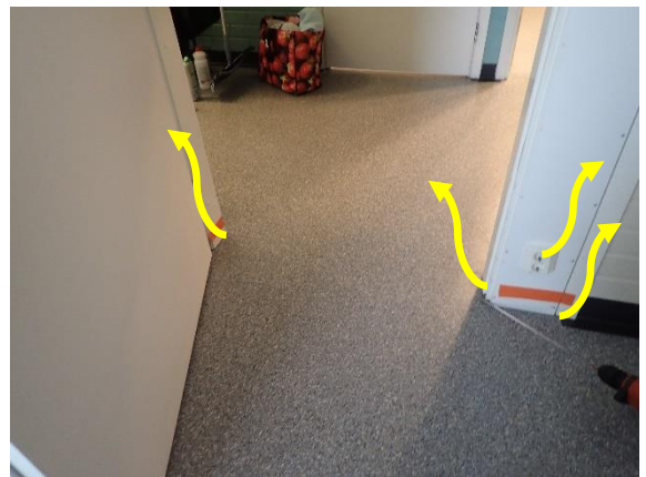
Kuva 63 Vuotoa havaittiin muuratun väliseinän liittymästä ovilevikkeen ja karmen kohdalta. Vuodon oletetaan aiheutuvan väliseinän harkkoperustuksen ja seinärakenteen välisestä epätiiveydestä ja jalkalistoituksen puuttumisesta havaintokohdalta.
