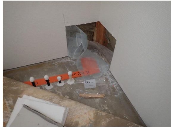
Kuva 79 US2. Rakenneavauksen sijainti. Ulkoseinän puurunko alkoi lattiapinnan tasosta. Alajuoksu oli painekyllästettyä puuta.
