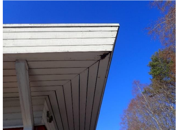
Kuva 64 Räystäslaudoituksissa paikoin kosteusjälkiä / -vaurioita.
