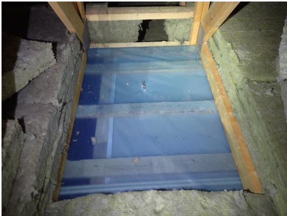
Kuva 147 YP2. Rakenneavaus sijaitsi kevyiden väliseinien linjalla ja yläpohjan korkeuseron kohdalla. Höyrynsulkumuovi oli yhtenäinen kevyiden väliseinien yli
