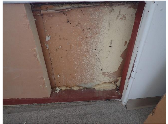
Kuva 85 US4. Sisemmät uretaanieristelevyt olivat runkoon liimaamattomia. Uretaanilevyjen välissä oli jälkiä merkittävästä ilmavuodosta. Levyjen takana oli ulkoa näkyvä betonisokkeli.
