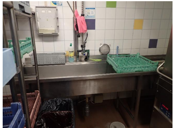
Kuva 108 Vauriokohdan toisella puolella oli lavuaareja, joiden tiedetään vuotaneen vettä lattialle.
