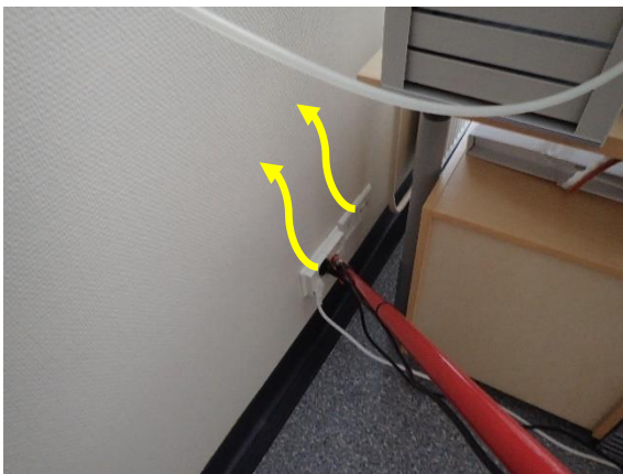
Kuva 62 Merkkiaineen vuotoa havaittiin sähköasennusten kautta. Sähköputkitusten oletetaan kulkevan alapohjan täyttöhiekassa.
