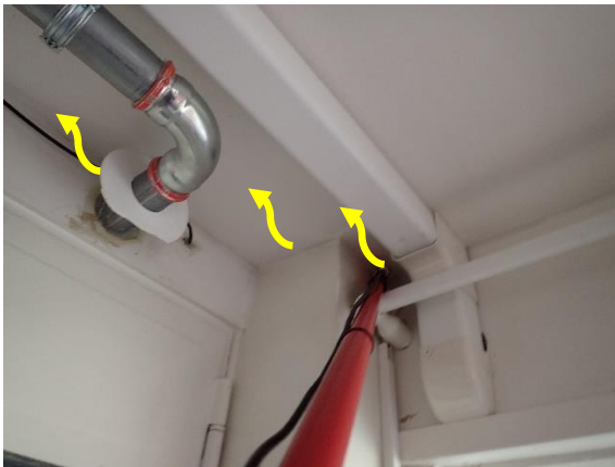
Kuva 236 Yhdyskäytävän suljettu ovi. Merkkiaineen vuotoa putkiläpiviennin ja teräspilarin kohdalta.
