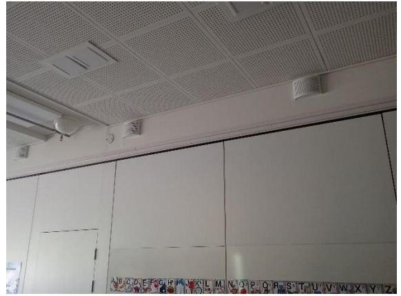
Kuva 206 Ryhmis. Siirtoseinän päällä oli kotelointi tuloilmakanavistoa varten.
