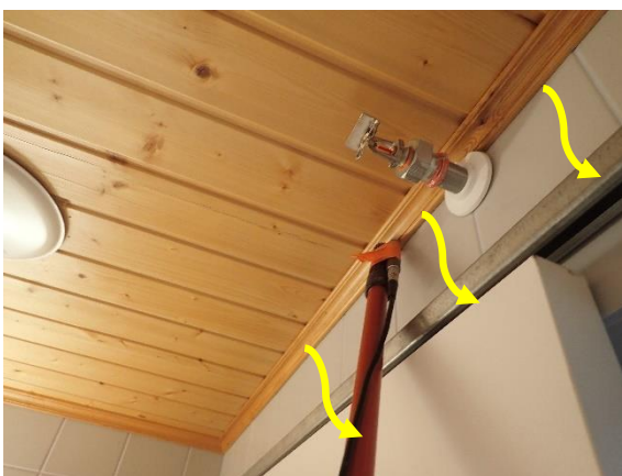
Kuva 135 MA 13 VS. Merkkianeen vuotoa havaittiin yläpohjan alaslaskutilasta listoituk-sen takaa.
