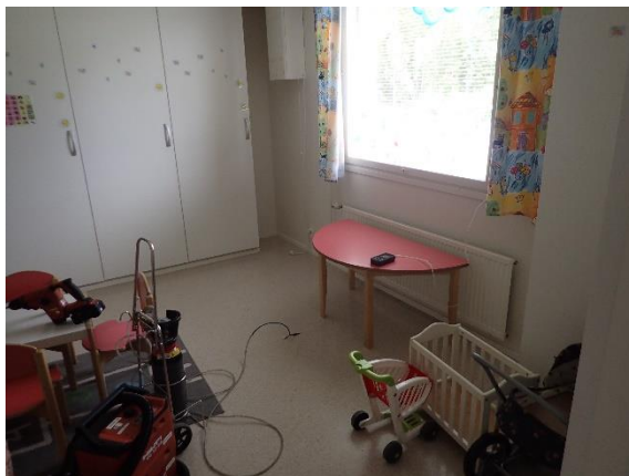
Kuva 58 MA 1 AP. Kaasunlaskupiste alapohjaan 1992 rakennuksessa, huoneessa 1.
