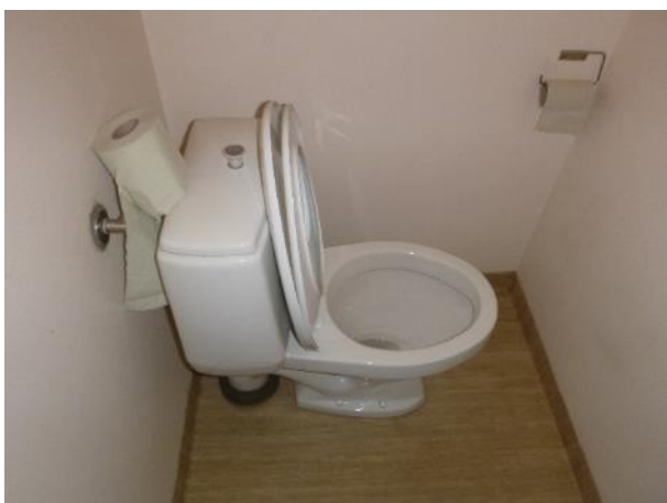
Vesi- ja viemärikalusteita.
