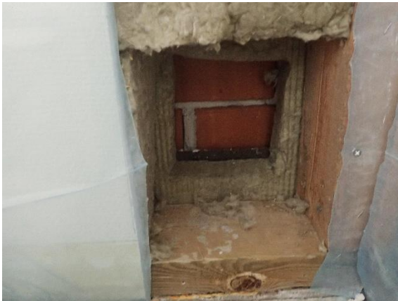
Kuva 86 US5. Ulkoseinän puurunko lähti lattia-pinnan tasosta. Alajuoksu oli painekylästettyä.
