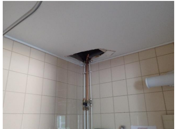
Kuva 208 1992 rakennus. Huonetilan 1 WC. Alakatoissa oli korjaamattomia reikiä paikallisesti, putkirikkojen kohdilla.
