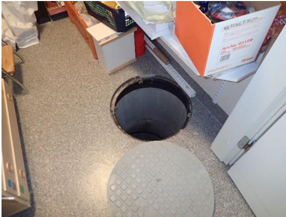
Kuva 52 Kodinhoitotuoneessa oli epätiivis valurautainen kaivon kansi.
