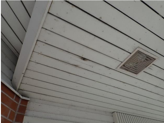
Kuva 63 Räystäslaudoituksissa paikoin kosteusjälkiä / -vaurioita.
