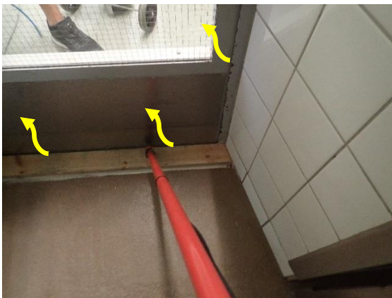
Kuva 238 Merkkiaineen vuotoa varapoistumistie-oven rakoista.
