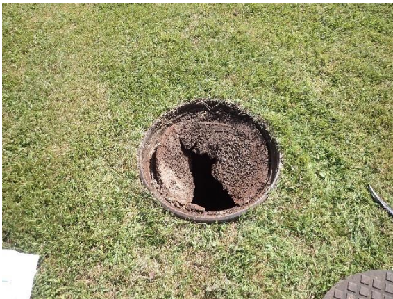
Kuva 18 Kulkukäytävän sisäänkäynnin edustalla oli kaksi kaivoa. Kaivojen välikansien kunto oli heikko. Toisen kaivon välikansi oli rikki ruostunut.
