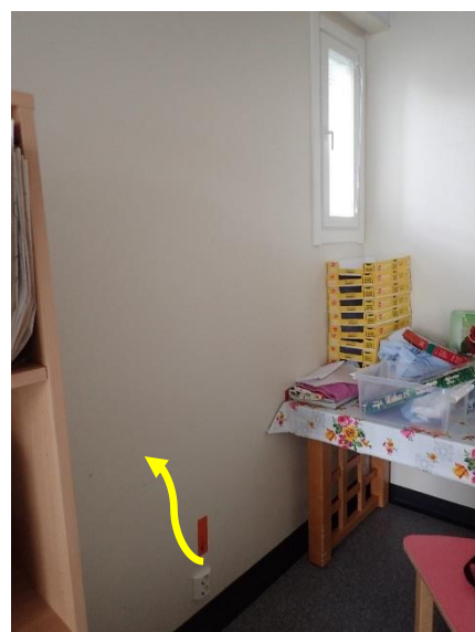
Kuva 99 MA 5 US. Merkkiaineen vuotoa sähköasennusten kohdalta.
