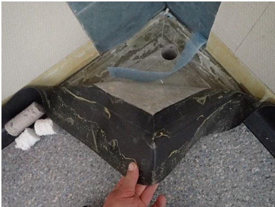
Kuva 50 Rakenneavaus AP5. Jalkalistat oli hitsattu kiinni muovimattoon.
