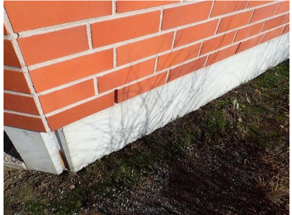
Kuva 31 Sokkelin ulkopinnassa ei havaittu vedeneristettä.
