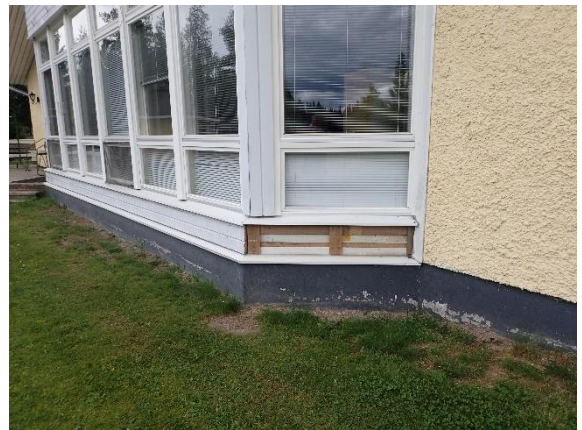
Kuva 93 Merkitäinekaasua laskettiin 1992 rakennuksessa ikkuna ja panelointi liittymiin ja ikkunan alle tuuletustilaan, ulkoseinään poratun reiän kautta.
