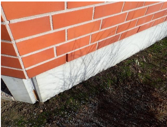
Kuva 10 Sokkelin ulkopinnassa ei ollut havaittavissa vedeneristettä.
