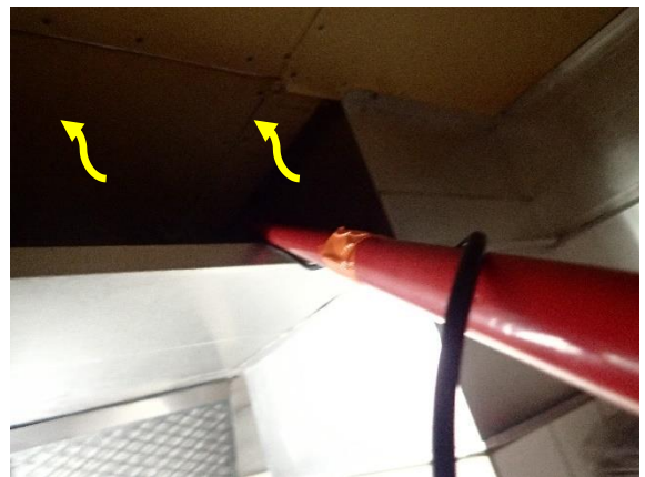
Kuva 245 Merkkiaineen vuotoa alakattotilasta huuvan kautta.
