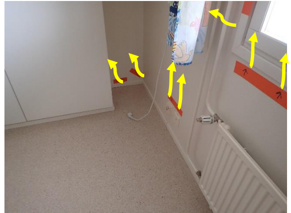
Kuva 101 MA 12 US. Merkkiaineen vuotoa edellisten lisäksi ulkonurkasta ja jalkalistoituksen takaa.
