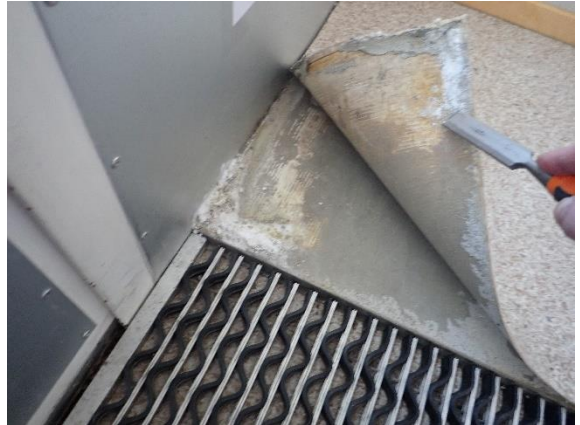
Kuva 43 Ulko-oven edustalla muovimaton alustassa havaittiin kosteusjälkiä.
