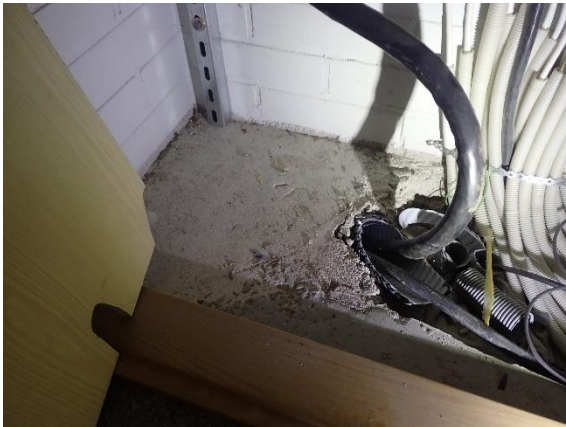
Kuva 54 2002 rakennuksen sähkökeskuksen lattian peittävän levyn alla oli epätiivittä lattian läpäiseviä asennuksia.
