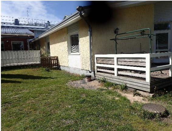
Kuva 8 Kuvassa rakennuksen vieressä on täytömaan painumisesta johtuvaa, helposti korjattavaa ongelmaa.
