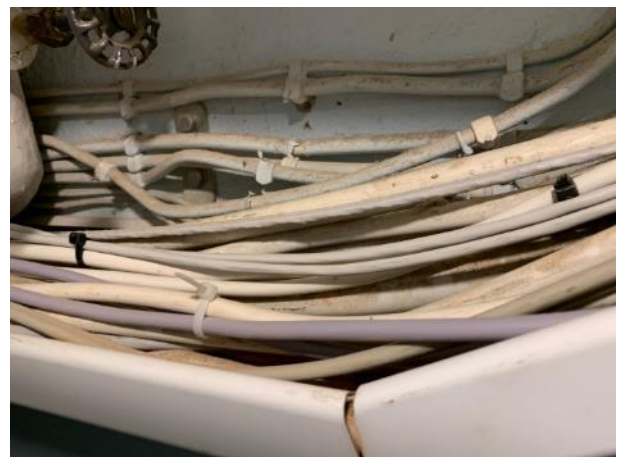
Tasopinnoilla esiintyvää pölyä.
