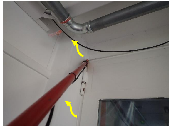
Kuva 237 Yhdyskäytävän suljettu ovi. Merkkiaineen vuotoa ovikarmin kohdalta vasemmasta reunasta.
