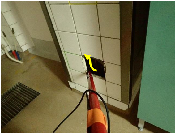
Kuva 248 Merkkiaineen vuotoa seinän koteloinnin sisältä.
