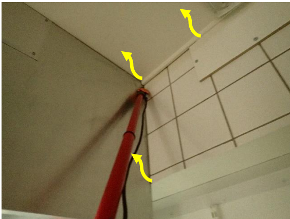
Kuva 242 Merkkiaineen vuotoa seinän nurkasta ja alakaton rajasta.
