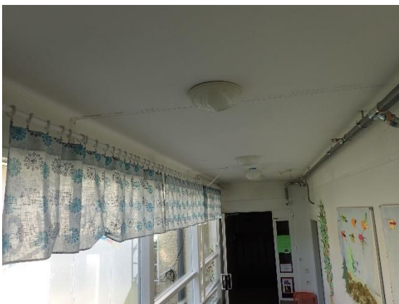
Kuva 209 Yhdyskäytävän katon kipsilevytyksen saumanauhat olivat säännönmukaisesti irronneet.
