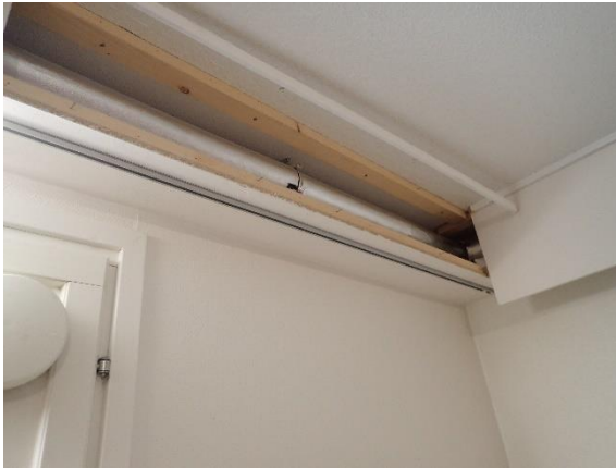
Kuva 78 US2. Ulkoseinien verhokotelossa kulki lämpöjohtolinjat. Ulkoseinän yläpään liitymä ei ollut sisäkautta avattavissa.
