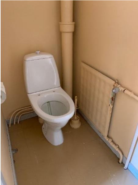
Vesi- ja viemärikalusteita.
