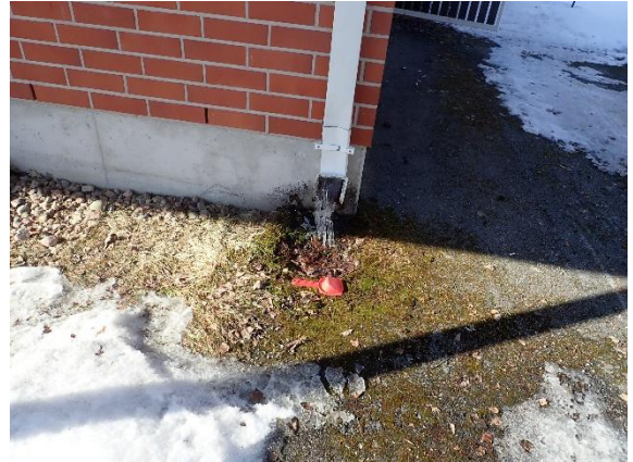
Kuva 9 Sadevesien poisohjauksessa esiintyy paikoin puutteita, mikä aiheuttaa sokkeleille lisääntyntä kosteusrasitusta.
