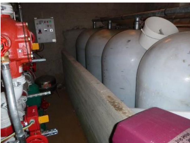
Yleiskuvia teknisistä tiloista.
