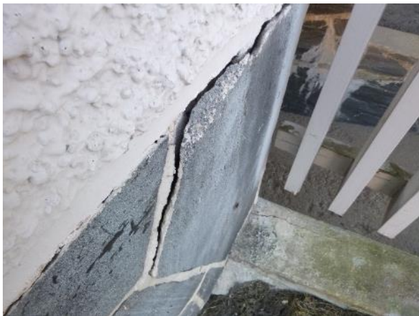
Sokkeli- ja seinärakenteessa on kosteuden aiheuttamia vauriojälkiä.
