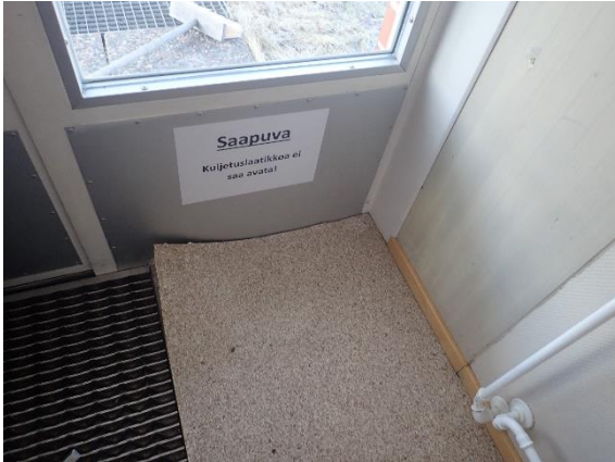
Kuva 42 Tuulikaapin lattiassa havaittiin pintakosteusmittauksin viitteitä poikkeavasta kosteudesta ulko-oven edustalla.
