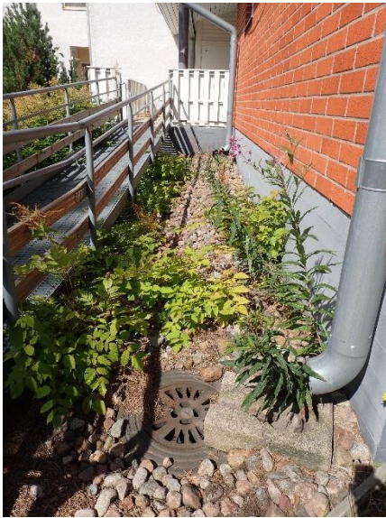
Kuva 16 2002 rakennuksen eteläkulmalla oli syöksytorven ulosheittoa jatkettu loiskekupilla.
