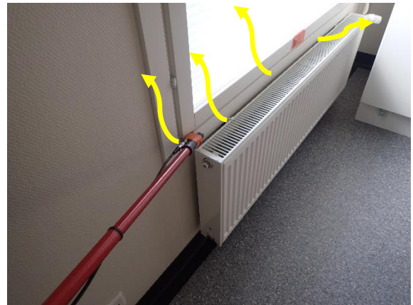
Kuva 95 MA 3 US. Merkkiaineen vuotoa ikkunaliittymästä.
