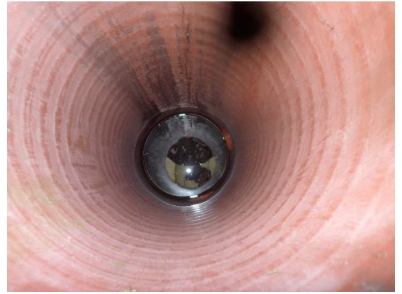
Kuva 11 2002 rakennetulla osalla salaojakaivot olivat muovikaivoja. Havaintojen perusteella kaivot olivat toimintakuntoisia.
