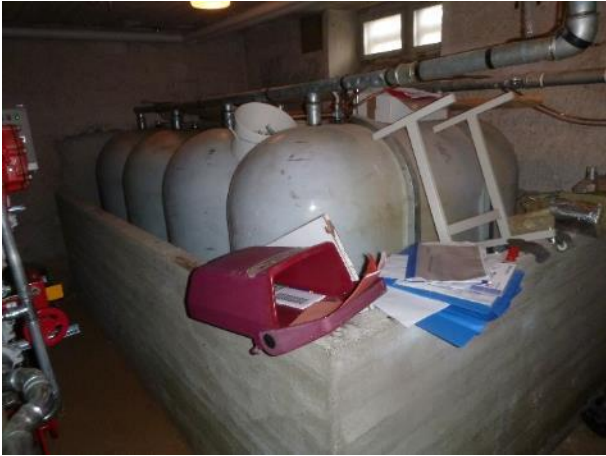
Yleiskuvia teknisistä tiloista.
