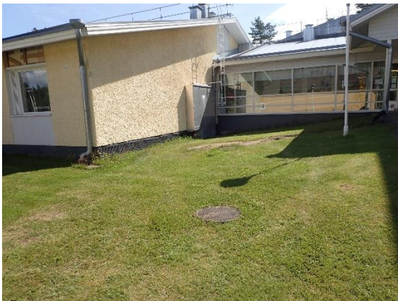
Kuva 6 1992 rakennusosan ja 1950-luvun rakennusosan väliin jää piha-alue, jolla pintavedet valuvat 1992 rakennusta kohden.
