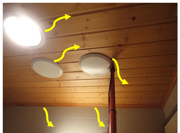
Kuva 136 MA 13 VS. Merkkianeen vuotoa havaittiin yläpohjan alaslaskutilasta alakaton läpivientien kohdalta.
