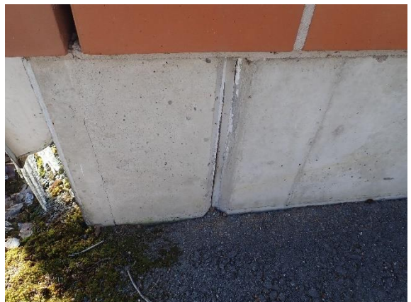
Kuva 29 Sokkeliementtien elementtisaumaukset olivat ikääntyneitä ja niissä esiintyi epätiivelyskohtia.
