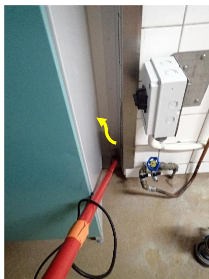
Kuva 247 Merkkiaineen vuotoa seinän koteloinnin sisältä.
