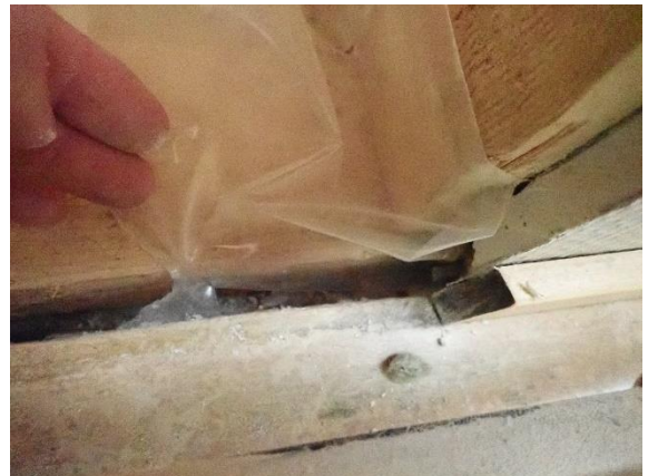
Kuva 23 Ilmansulkumuovi päättyy alajuoksun vierelle - ilmansulun tiiveydessä todettiin yleisesti puutteita (US3).
