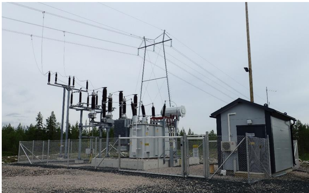
Kuva 17. Esimerkki tuulivoima-alueen sähköasemasta (Kuva: FCG).
