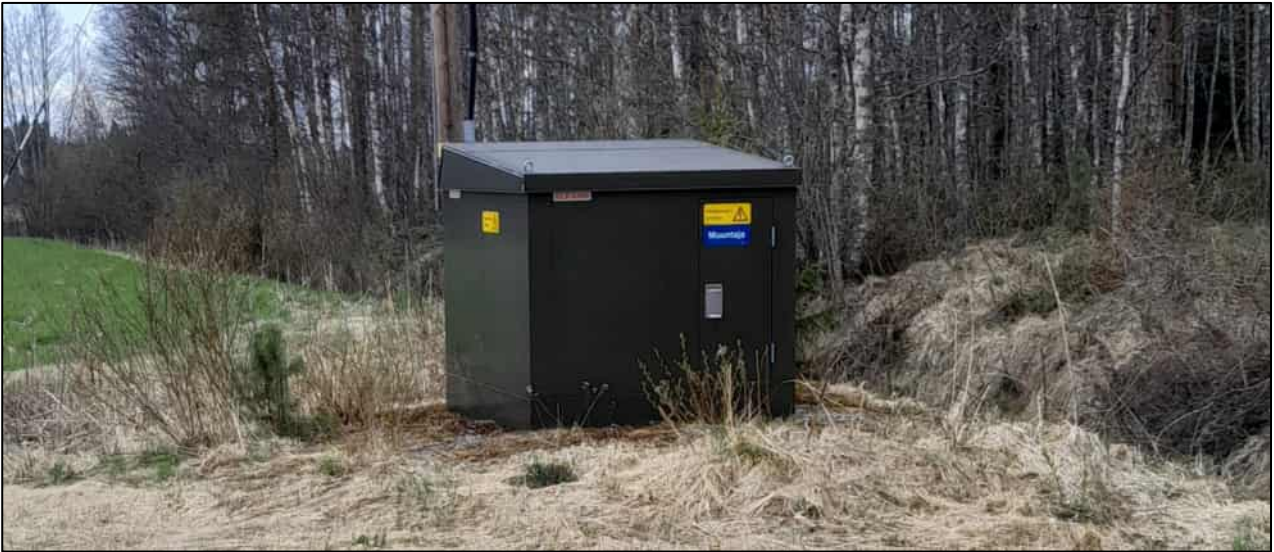
Kuva 21. Puistomuuntamo Laineskankaan pohjavesialueella.
