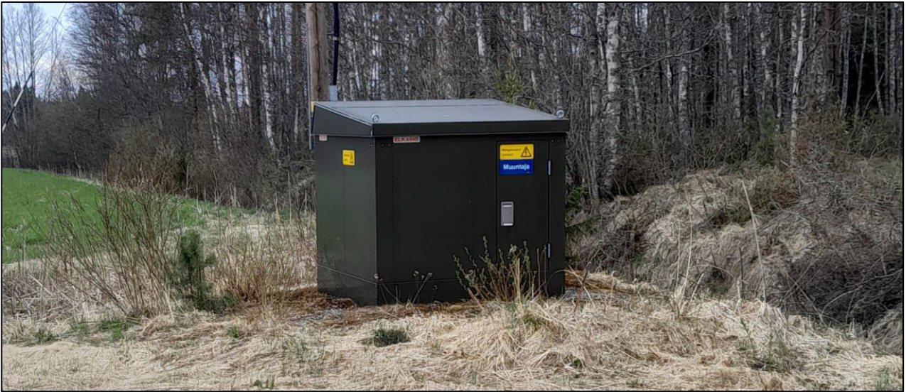
Kuva 21. Puistomuuntamo Laineskankaan pohjavesialueella.
