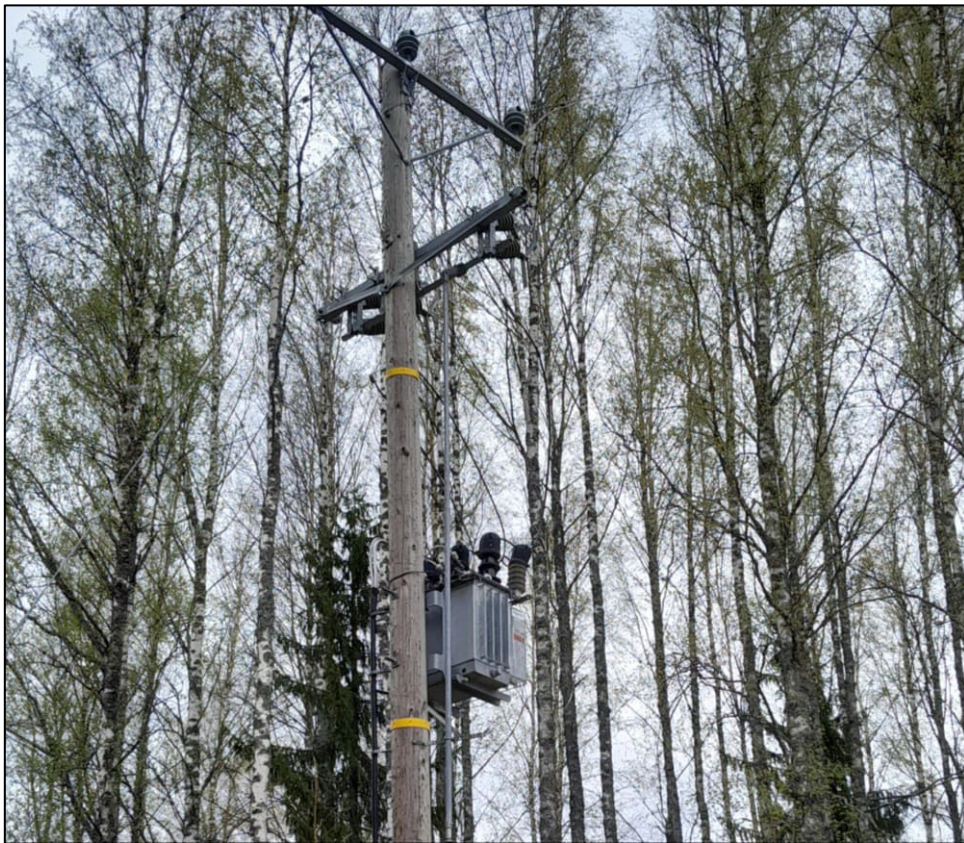
Kuva 22. Pylväsmuuntamo Heiskanmäen pohjavesialueella.
